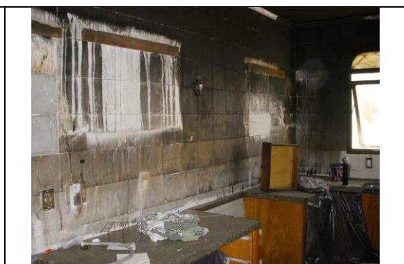
Foto 04. Vista da cozinha sem revestimentos e armários
