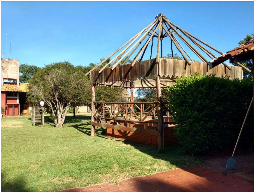
17. Vista quiosque sem cobertura
