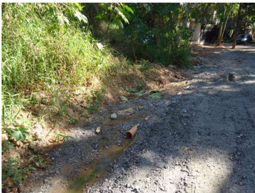
FOTO 11 – Valeta lateral para escoamento superficial junto à divisa do terreno, com tubo captador e presença de água por ocasião da vistoria
