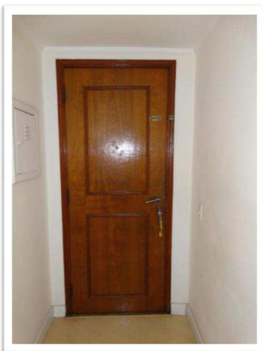
Foto nº 18 - Vista interna da porta de entrada do Apartamento nº 178 do Bloco B.
