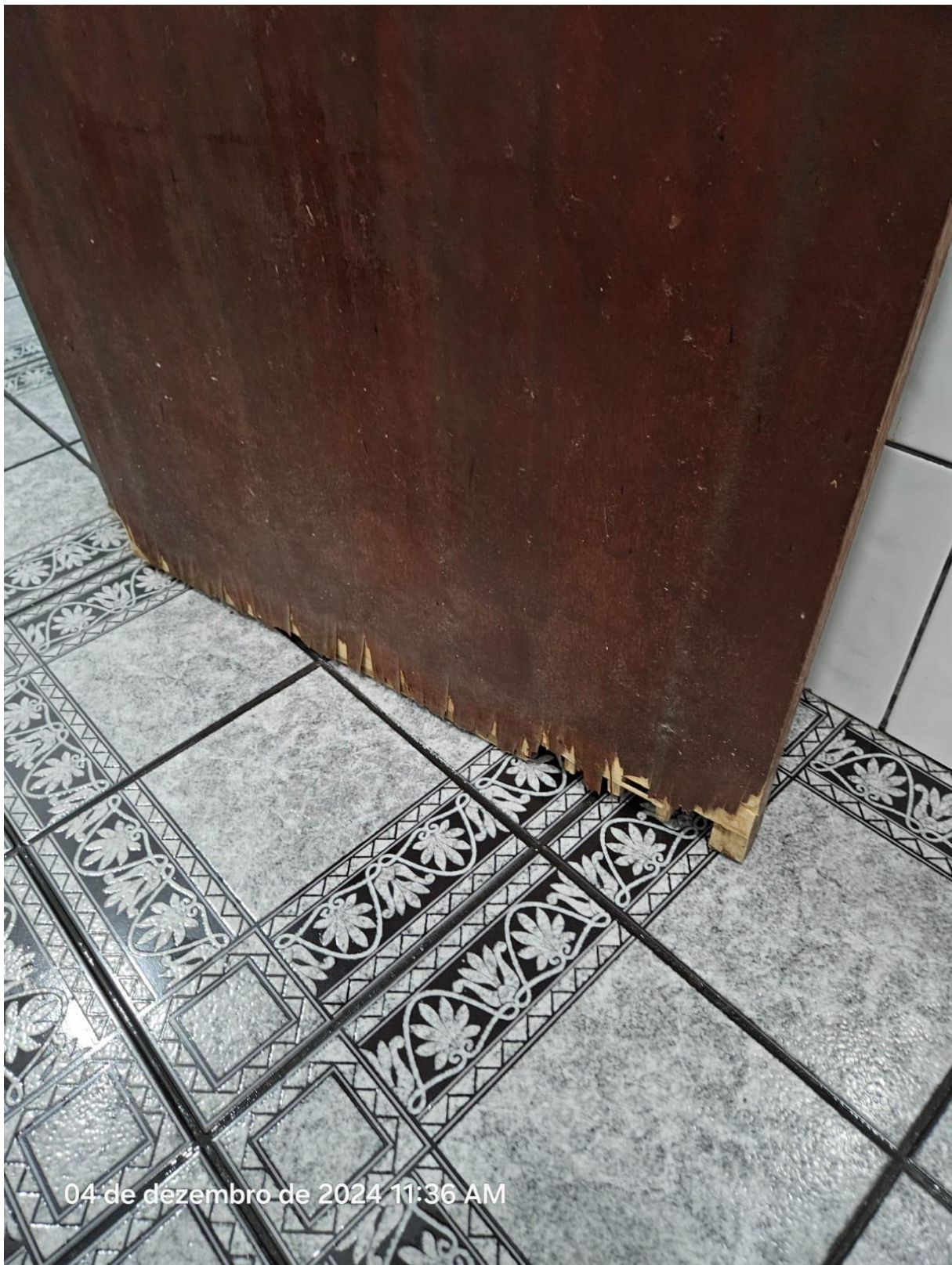
FOTO 12: AVARIAS PORTA BANHEIRO – PRIMEIRO ANDAR
