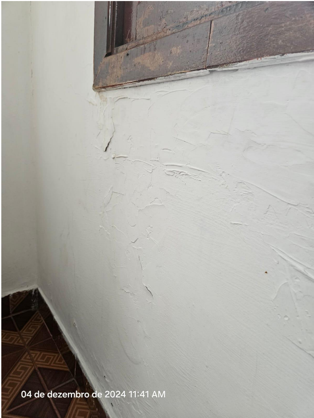
FOTO 23: AVARIAS PAREDE DORMITÓRIO – SEGUNDO ANDAR
