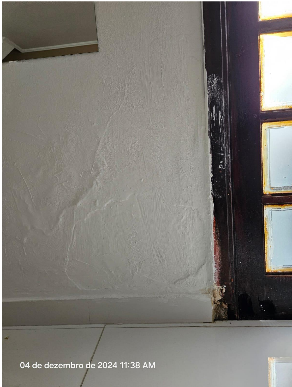
FOTO 14: AVARIAS PAREDE E ESQUADRIA PORTA SALA DE ESTAR – PRIMEIRO ANDAR
