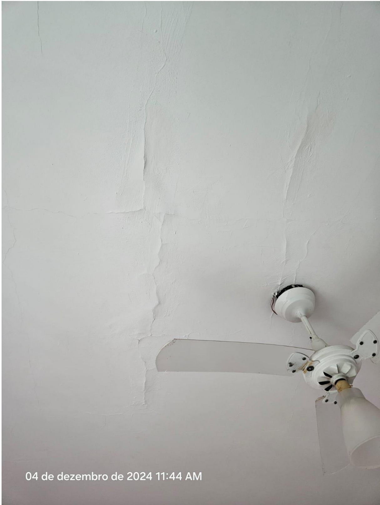
FOTO 24: AVARIAS TETO DORMITÓRIO – SEGUNDO ANDAR
